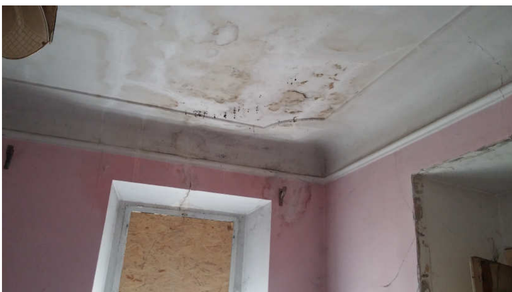
Napadené části dřevokaznými houbami krovu, stropu, pohledu.
