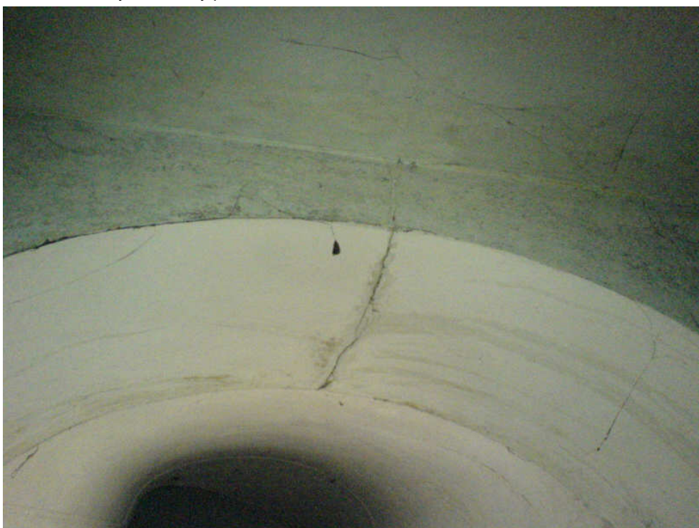
Typické poruchy kleneb P02.
