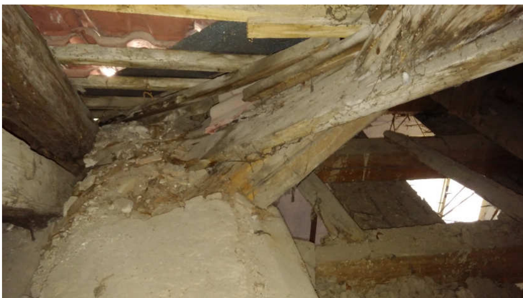
Rekonstrukce krovu P04 – napadené části dřevomorkou.
