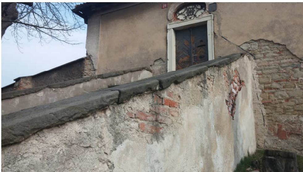
Nefunkční zákrytové desky předsazeného schodiště.
