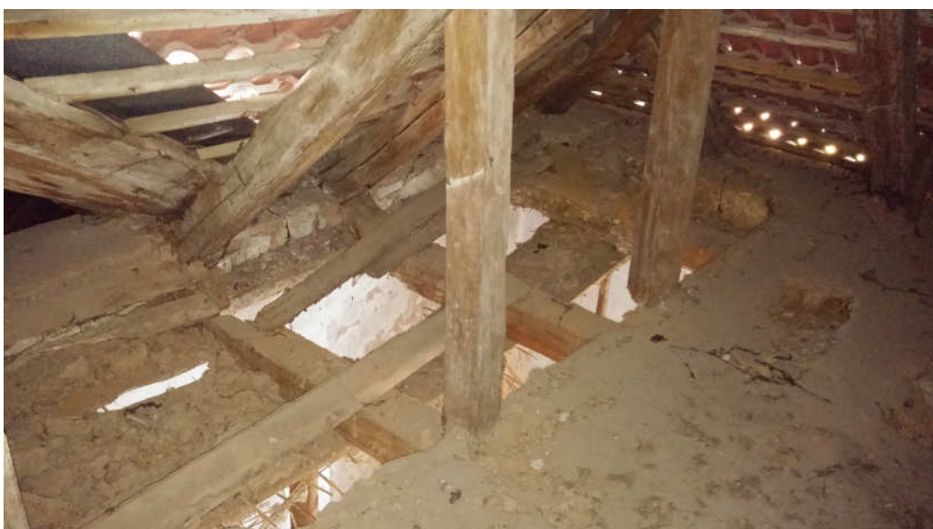
Rekonstrukce krovu P04 – napadené části dřevomorkou.
